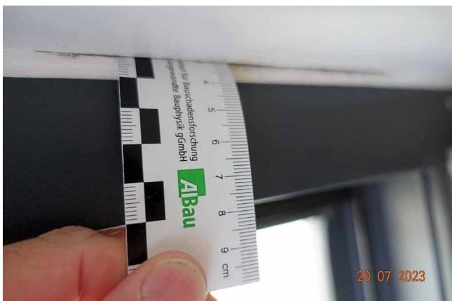
Abb. 7 a, b: Offene Fuge des Rollokastens über der Fenstertür
