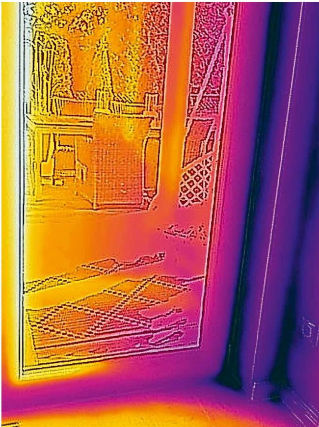
Abb. 2: Thermografie-Aufnahme des beanstandeten Bereichs des Fensterflügels
