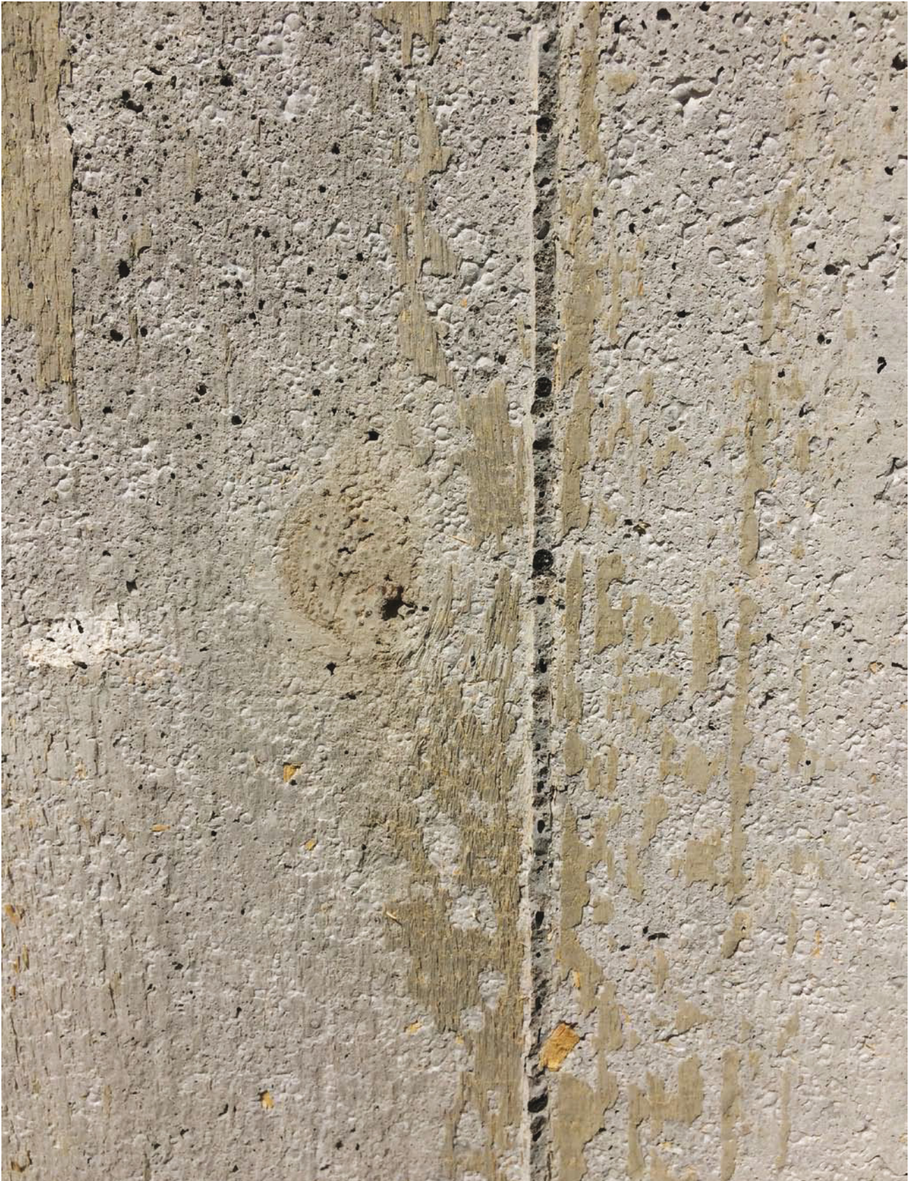
Die Zementschlämme auf den sägerauhen Brettern ist beim Ausschalen teilweise an der Betonoberfläche haften geblieben.
