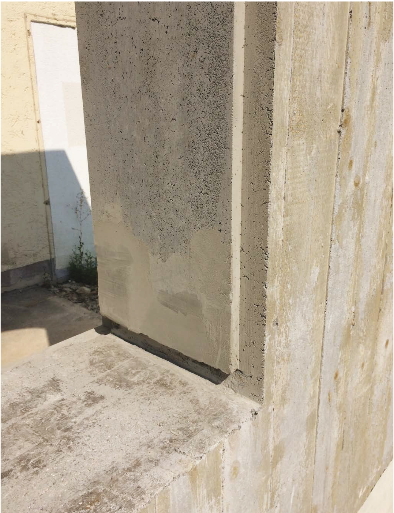
Im Bereich der Aussparungen zur Überdeckung des Fensterblechs kam es beim Ausschalen zu Ausbrüchen, die ausgebessert werden mussten.
