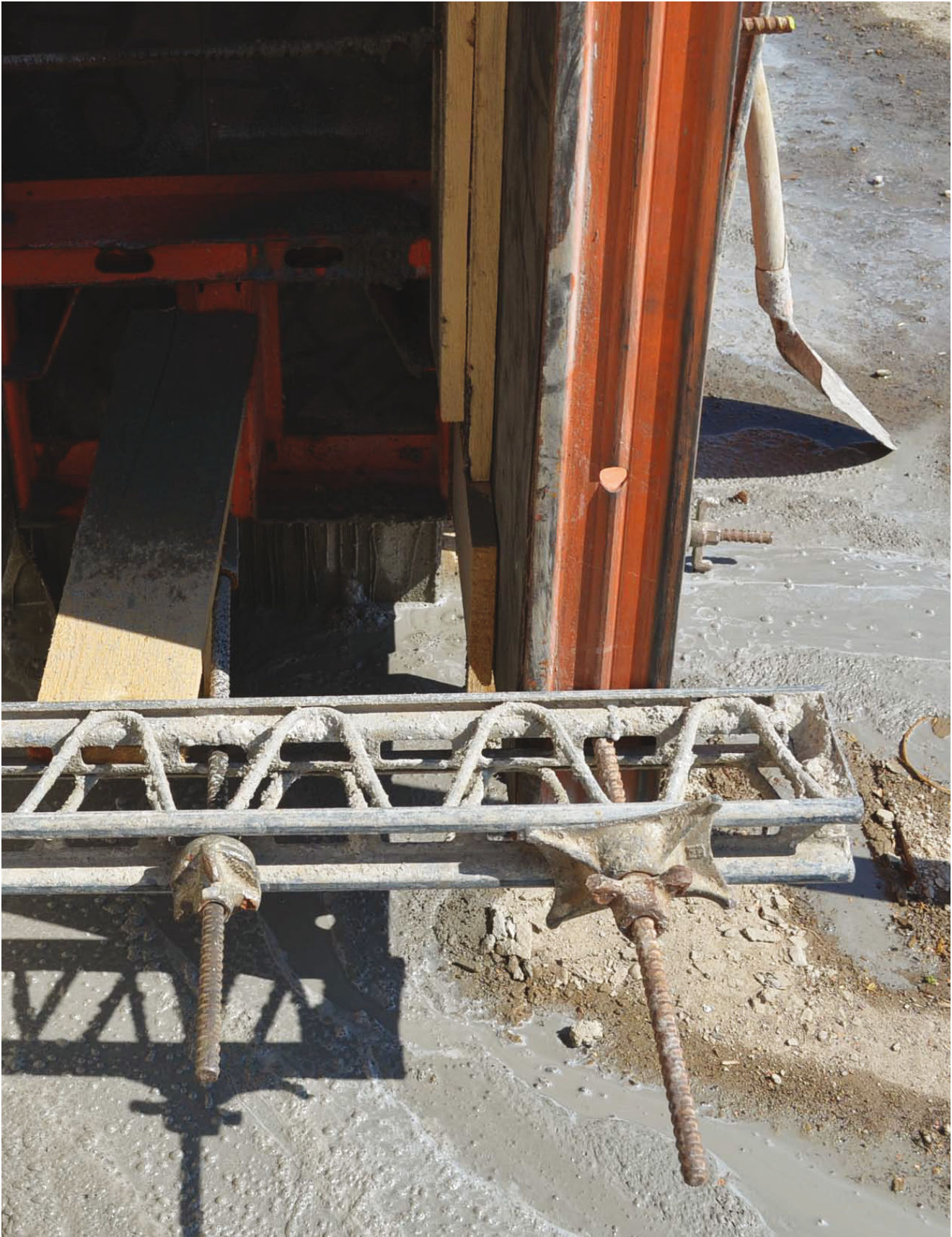
Im Bereich der Schalungsfugen trat während des Betoniervorgangs eine größere Menge Betonmilch aus
