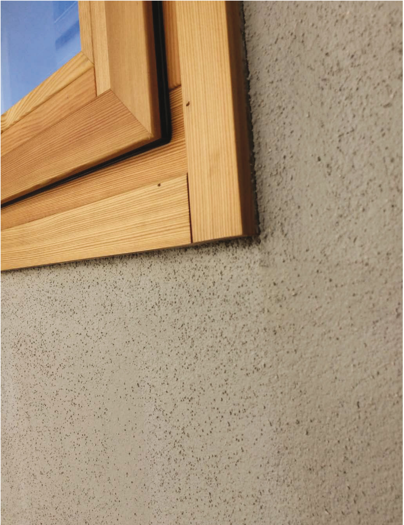
Gefitzte Wandschlämme auf der Innenseite der Mauerwerkswand
