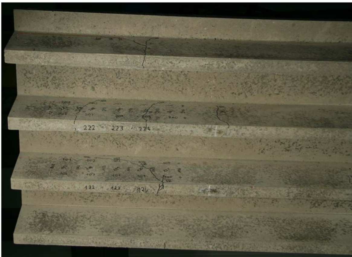
Abb. 7-12: Untersicht Versuchskörper A-I, abgeschlossenes Rissbild
