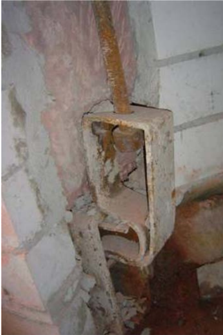
Abb. 3-17: An diesem Stahlanker hängt ein Balkon
