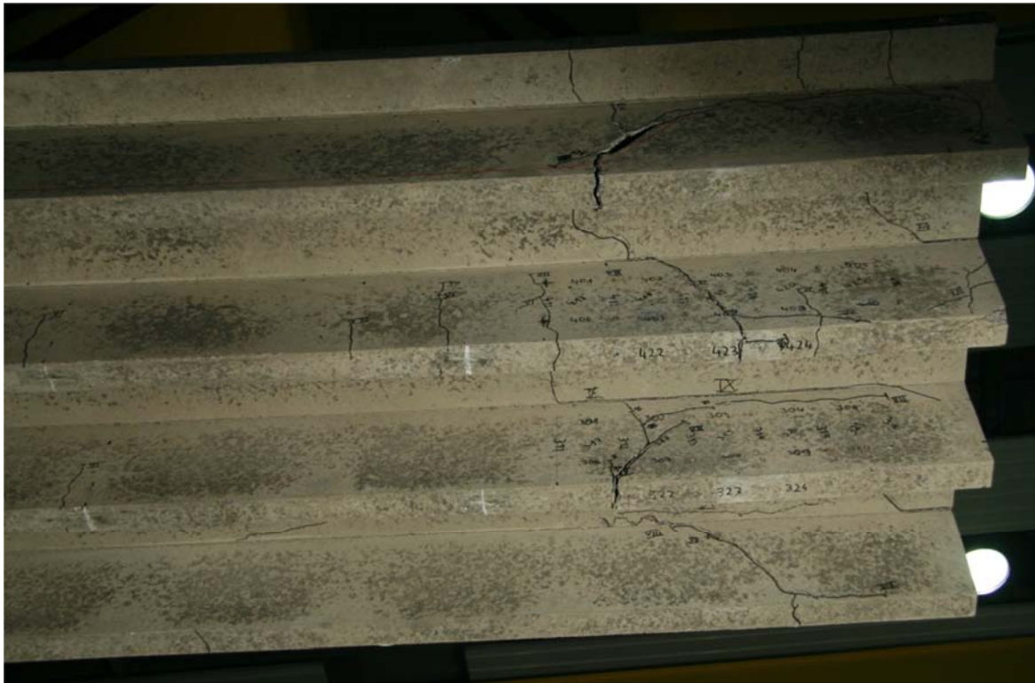
Abb. 7-11: Untersicht Versuchskörper A-I, abgeschlossenes Rissbild
