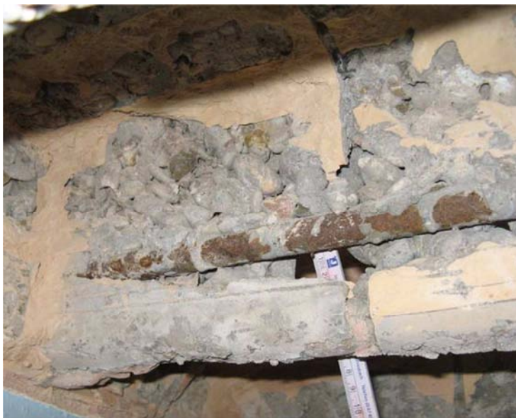
Abb. 3-2: Angetroffener Zustand der Rippendecken – freiliegende Bewehrung
