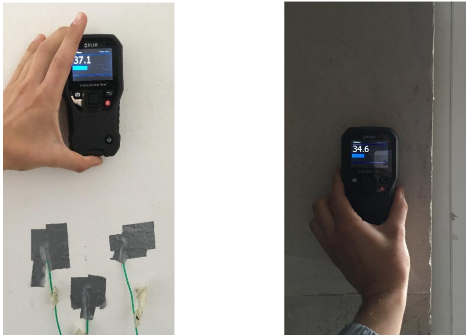
Abbildung 50: Links: Materialfeuchtegehalt Außenwand Ost/ Wohnzimmer; rechts: Materialfeuchtegehalt Außenwand West/ Küche
