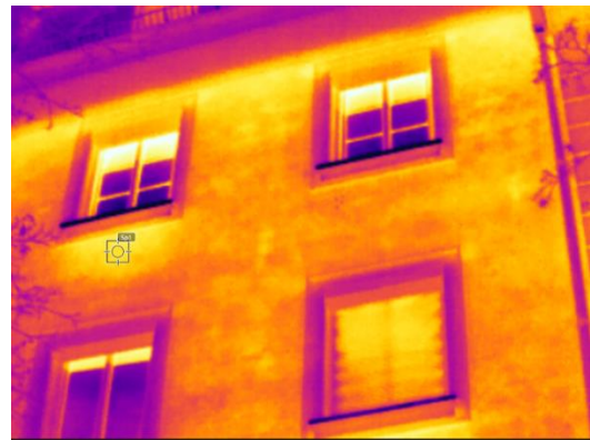
Abbildung 36: Thermografie Außenfassade, Bildausschnitt 2 x 2 Fenster
