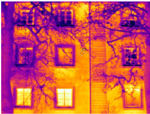
Abbildung 35: Thermografie Außenfassade, Bildausschnitt 3 x 3 Fenster
