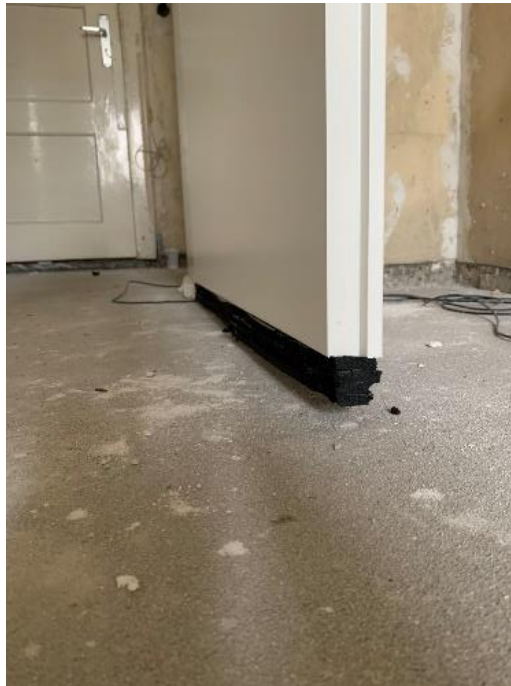
Abbildung 78: Innentür mit Armaflex
