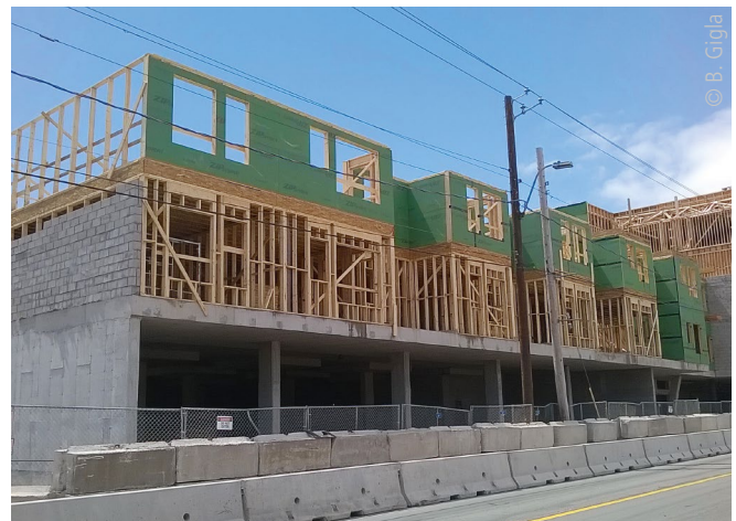
Abb. 2: Gemischt genutztes Gebäude mit Wohnungen, Läden und Büros mit Wänden in Holzbauweise im Rohbau (Foto aus Halifax, Kanada)
