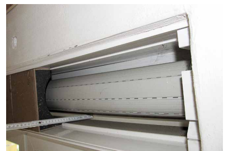
Abb. 8: Gurtdurchführungen durch einen wandintegrierten Rollladenkasten (Die rechte Schalldämmeinlage wurde zur visuellen Untersuchung ausgebaut, die rechte, unbenutzte Gurtdurchführung ist eine Schwachstelle der Schalldämmung)
