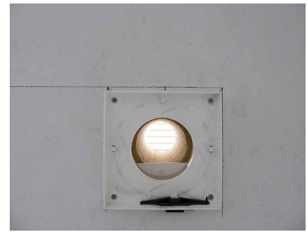
Abb. 5: Kernbohrungen für Lüftungszwecke reduzieren die Luftschalldämmung einer Außenwand
