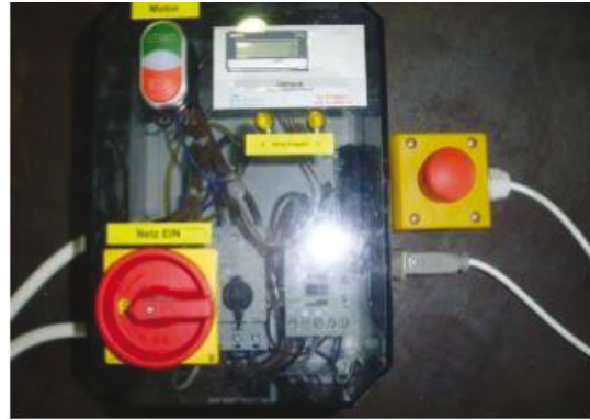
Abbildung 53: Schaltkasten mit Zählwerk und Notausschalter
