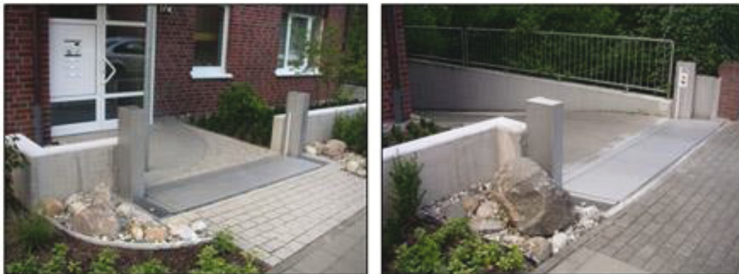
Abbildung 11: Eingebaute Klappschotts der Firma Anhamm, links am Hauseingang, rechts an der Zufahrt zur Tiefgarage [Quelle: http://www.architekten24.de/produkte/produkte-ueberschwemmungsschutz/8626-anhamm-ueberschwemmungsschutz-klappschott/index.html Zugriff am: 18.06.2016]
