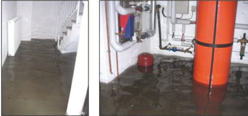
Abbildung 10: Links der Eingangsbereich und rechts der Heizungskeller, der Knie tief unter Wasser stand [Quelle: http://www.architekten24.de/produkte/produkte-ueberschwemmungsschutz/8626-anhamm-ueberschwemmungsschutz-klappschott/index.html Zugriff am: 18.06.2016]
