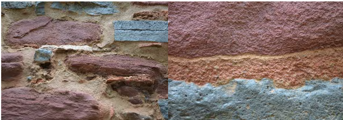
Bilder D1.13 und D1.14: Details aus Bild D1.12 mit partiellen Abschaltungen des Verfumörtels und sinterartigen Verkrustungen auf den Oberflächen (Bild D1.13). Die Schäden können u.a. durch Belastungen (Feuchte, Salze) aus dem Mauerwerk bedingt sein. Im Bild D1.14 sind die Steinflanken des weichen Sandsteines im direkten Kontakt zum Verfumörtel wegen hoher Festigkeiten des Verfumörtels (Die Festigkeiten wurden auf den Kalkstein abgestimmt.) zurückgewittert.
