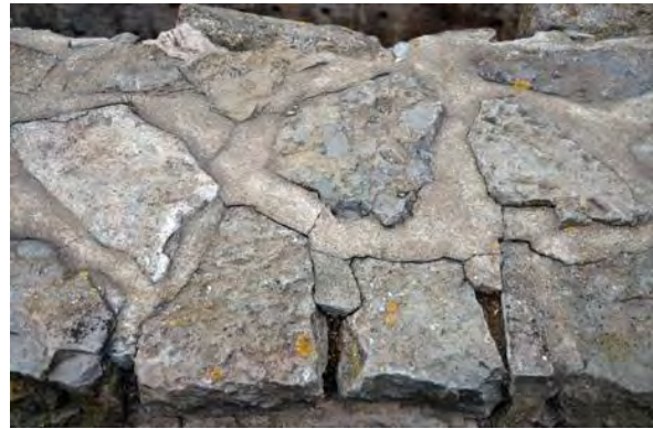
Bild 26: Mauerkronenbereich zu Bild 26: Es kam zu Flankenabrissen der Verfugung und nach Wassereinträgen zu Frostschäden.
