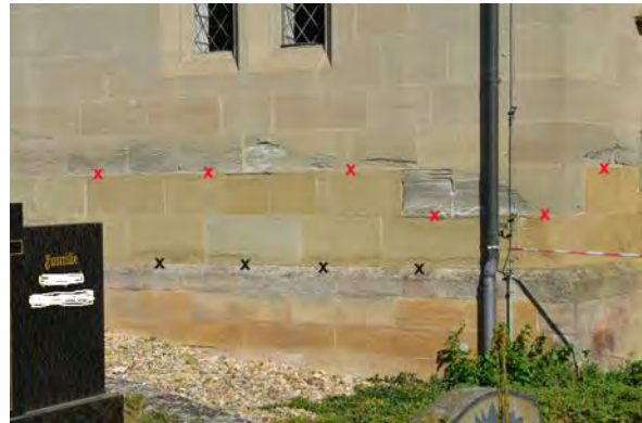
Bild 12: Quadermauerwerk mit vorgeblendeten Sandsteinplatten nach starker Rückwitterung (Die Kreuze kennzeichnen den verblendeten Bereich über dem Sockel.)
