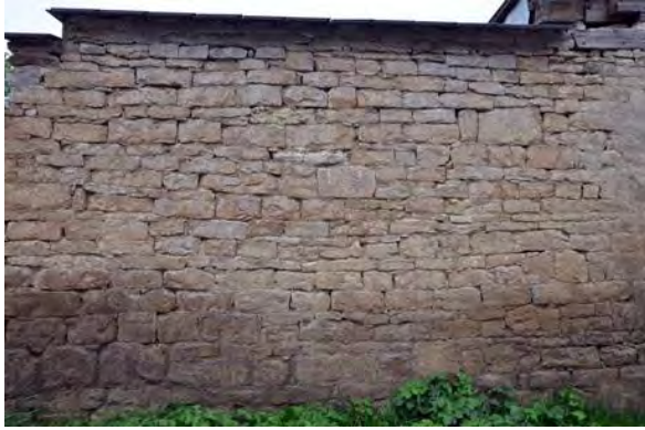
Bild 17: Kalksteinmauer mit neuer Mauerkronenabdeckung und Feuchtehorizont im unteren, rückseitig erdberührten Bereich
