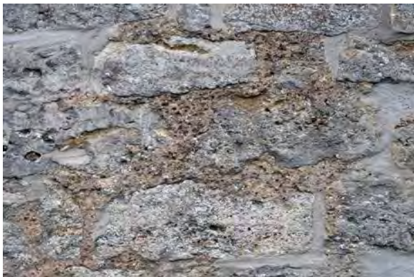
Bild 15: Kalksteinmauerwerk mit Fugenreparaturen unterschiedlicher Art nach Schäden durch Feuchteinträge über die Mauerkrone
