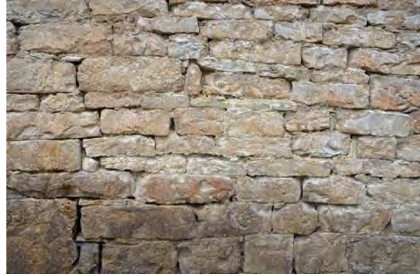
Bild 18: Detailansicht zu Bild 17 mit Übergangsbereich zwischen feuchtem und trockenem Mauerwerk
