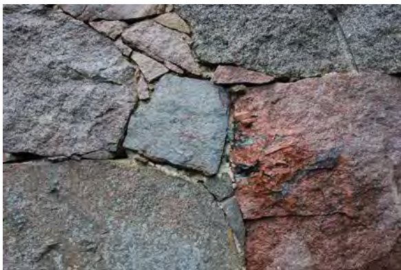
Bild 1: Bruchsteinmauerwerk aus gespaltenen Findlingen mit hohem Zwickelanteil aus Findlingsbruch ohne nachträgliche Verfugung mit oberflächennahen Mörtelauswitterungen
