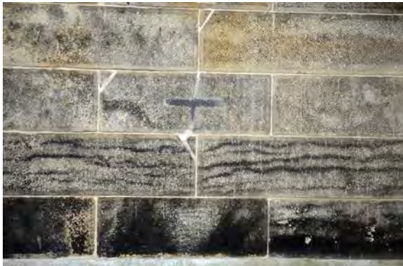
Bild 21: Quadermauerwerk aus Elbsandstein in geschützter Exposition mit starker Verschmutzung
