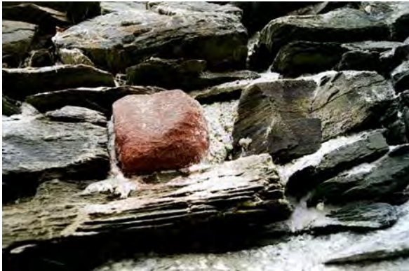
Bild 7: Mauerwerk einer Stützmauer aus Schiefergestein mit tiefen Auswitterungen der Gipsmörtel als Folge von höheren Dolomitanteilen im Gips und rückseitigem Wassereintrag
