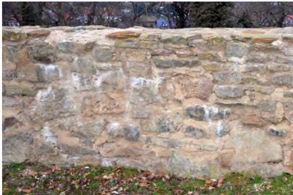
Bild 25: Neu aufgebaute Mauer nach wenigen Jahren Standzeit mit Schäden im Mauerkronenbereich und Kalkauswaschungen an den Wandflächen
