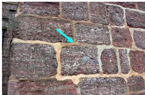
Bild 10: Quadermauerwerk aus Wartburgkonglomerat mit verschiedenen Ausbesserungsmörteln in den Fugen und Bestandsmörtel (Pfeil) mit Romanzement als Bindemittel
