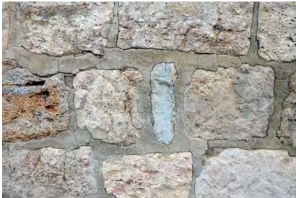
Bild 11: Mauerwerk aus Kalkstein und Travertin aus Altsteinen wenige Jahre nach der Neuerrichtung
