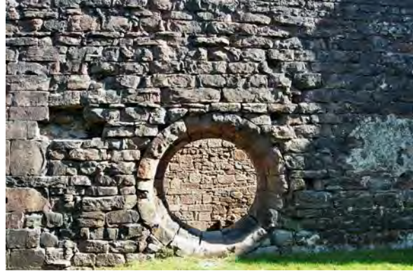
Bild 6: Wand mit stark zurückgewitterten Fugen im Natursteinmauerwerk in einer ehemaligen Klosterkirche mit Brand Schäden an Steinen
