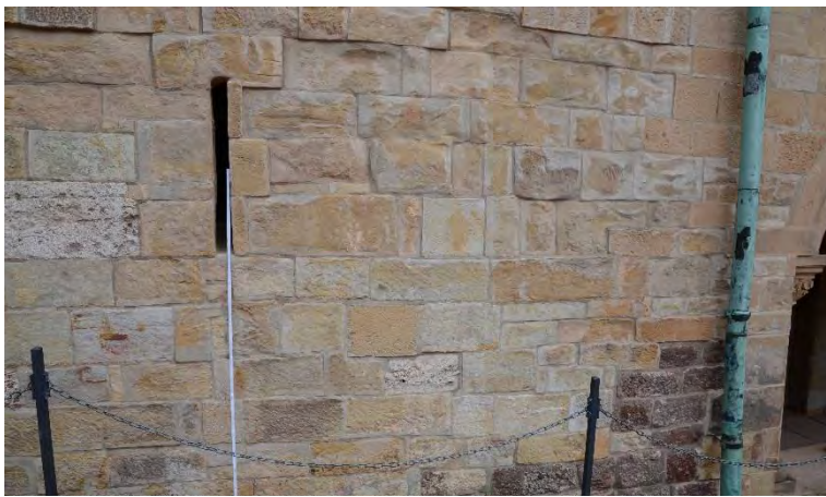
Bild D5.11 und D5.12: Detail aus Bild D5.10: Vorwiegend intakte Reparaturmaßnahme aus dem Jahr 1996 nach 18 Jahren Standzeit (Baustellenmischung). Partiiell sind Auswaschungen an den Vertikalfugen im Anschlussbereich von Rätsandstein und Altmörtel an den Fugenflanken vorzufinden.
