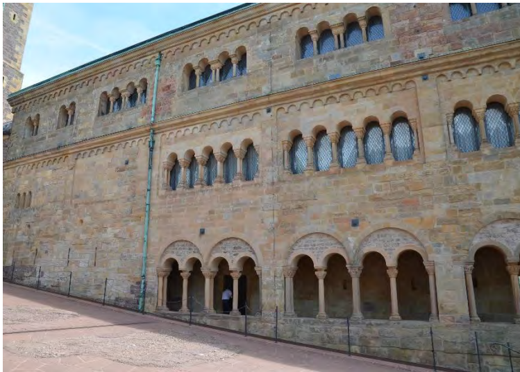
Bild D5.10: Teilansicht von Wandflächen der Westfassade des Palas aus der Sanierungsphase 1995-1996: Die Sonderrezeptur enthält natürlich hydraulischen Kalk und Zusätze von HS-Zement als Bindemittel und feine Quarzsande als Gesteinskörnung.
