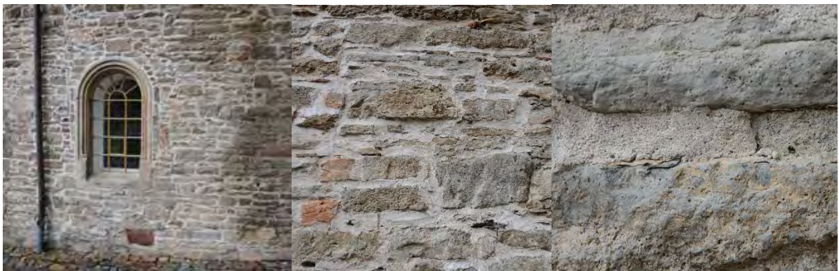
Bilder D1.6 bis D1.8: Teilansicht und Details von Fugenausbesserungen: Die neuen Verfugmörtel sind häufig dünnschichtig über den Altmörtel gezogen worden. Ein Zurückarbeiten der Altmörtel erfolgte scheinbar nicht. Der Ausbesserungsmörtel ist sehr weich und partiell durch Feuchte- und Salzbelastungen aus dem Untergrund geschädigt. Der „neue“ Mörtel ist in Schichtdicken bis 1,5 cm aufgetragen und lässt sich leicht vom Altmörtel ablösen. Die Art der Ausführung ist als „Opferverfugung“ für kürzere Lebensdauern anzusehen.
