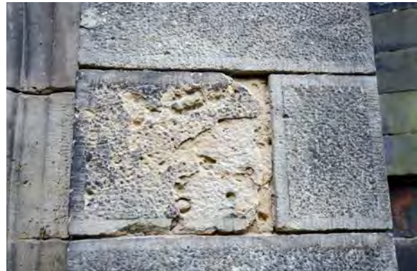
Bild 22: Quadermauerwerk aus Elbsandstein in stärkerer Bewitterung mit Steinschäden und ausgewitterten Fugen
