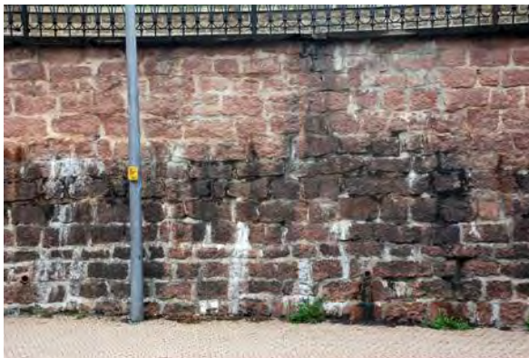
Bild 19: Stützmauer mit rückseitiger Erdanschüttung wenige Jahre nach Sanierungsmaßnahmen
