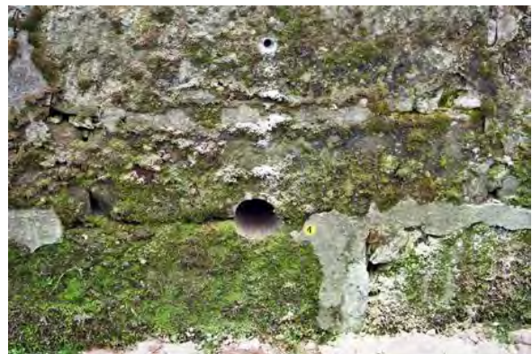
Bild 28: Detail zu Bild 27: Wasser und Salze von der Straße dringen direkt in das Mauerwerk ein und führen zu hohen Belastungen.
