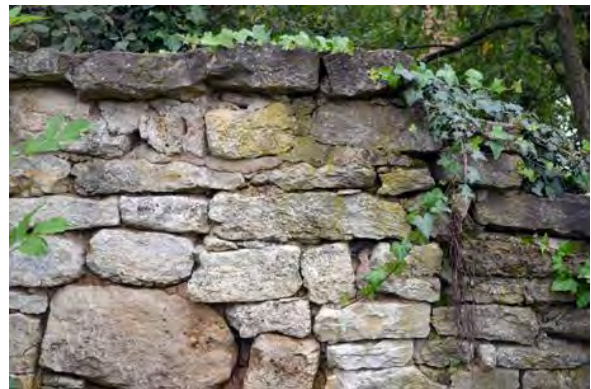
Bild 16: Notdürftig abgedeckte frei bewitterte Kalksteinmauer mit beginnenden Zerfallerscheinungen durch Feuchteinträge über rückwärtig anstehendes Erdreich
