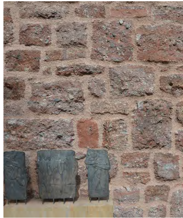
Bild D5.6: Detail aus Bild D5.5: Neu verputzte Wandflächen ohne Schädigung der Verfugung nach drei Jahren Standzeit.
