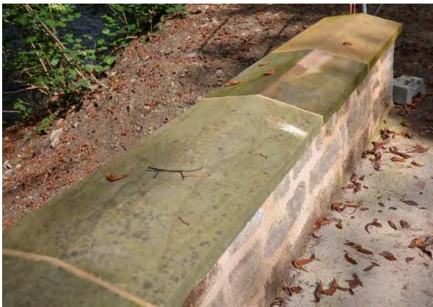
Bild D6.3: Abdeckung der Mauer mit Sandsteinplatten: Die Grünfärbung zeigt bereits Besiedlungen mit Algen und Flechten an. Die historischen Abdeckplattenmaterialien waren Berkaer Sandstein und Muschelkalk. Spätere Ausbesserungen erfolgten mit Cottaer Sandstein. Reste aus diesen Beständen wurden wiederverwendet und Fehlbestände mit Abdeckplatten aus Nebraer Sandstein ergänzt.
