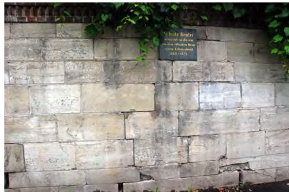
Bild 20: Stützmauer mit Verformungen durch rückseitigen Erddruck oder durch voluminöse Wurzeln
