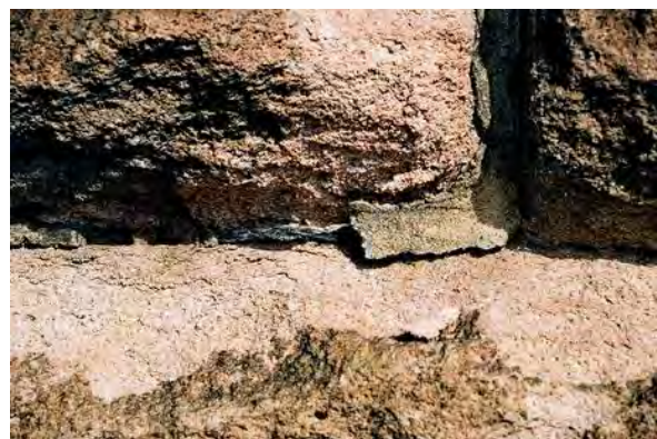
Bild 24: Detail zu Bild 23: Die Fugenränder sind angewittert und eine nachträgliche Reparatur mit Verfugmörtel löst sich ab.
