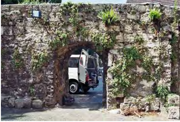
Bild 5: Bruchsteinmauerwerk aus Kalkstein und Travertin mit starkem Bewuchs infolge Wassereintrag über die Mauerkrone
