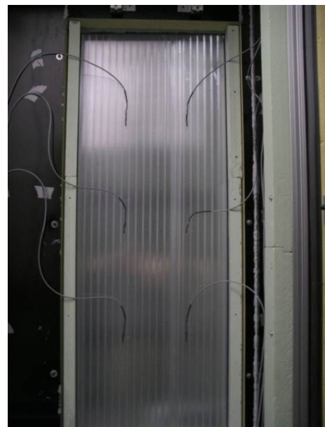
Abbildung 2.14: Oberflächentemperatursensoren (PT100) Stegplatte Innen
