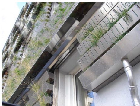
Abb. 3.4: Modulare WB Typ „Kleine horizontale Kübel“ in Wien in Metallausführung, Detailansicht.
